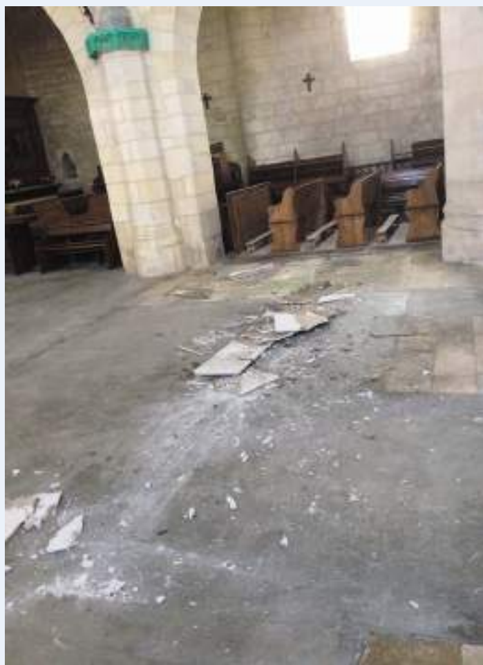
Nouvelle chute de plaques de plâtre en décembre 2016.
